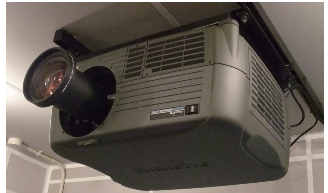
Photo. 2 The projector installed in the shielded room シールドルーム内に設置したプロジェクター
